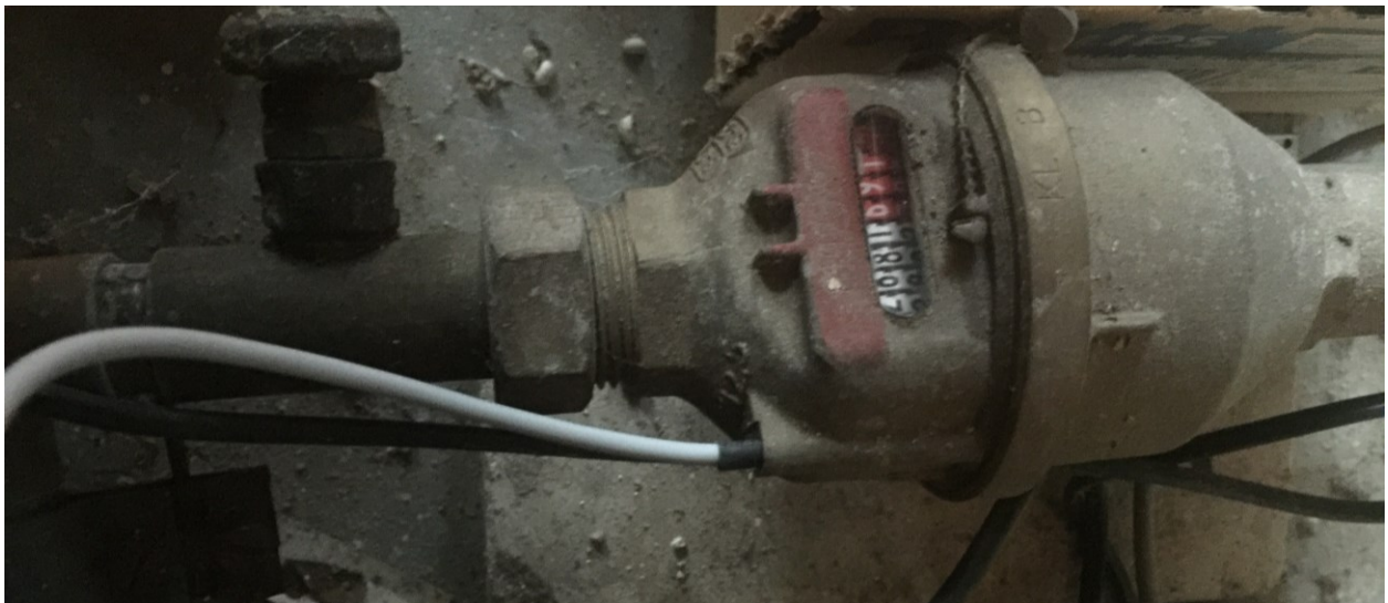
Insteken in water meter
